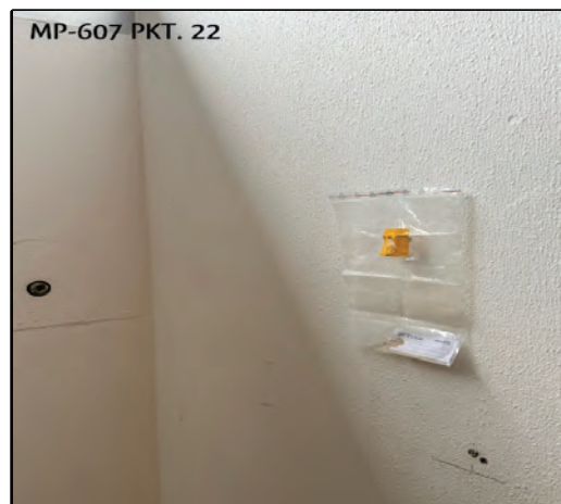
Bild 24: MP607-Pkt. 22, EG/OG/KG, Wandputz innen -- Mischproben
