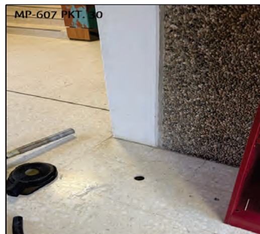
Bild 36: MP607-Pkt. 30, EG Flur, Kleber Steinfliese
