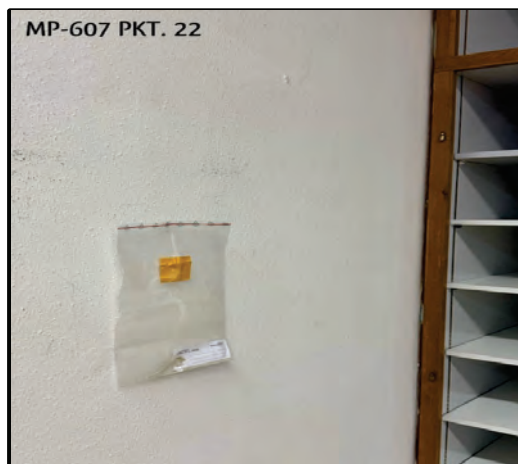
Bild 23: MP607-Pkt. 22, EG/OG/KG, Wandputz innen -- Mischproben
