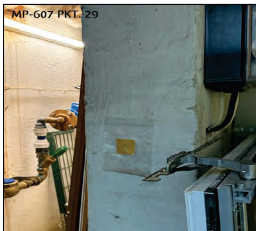
Bild 33: MP607-Pkt. 29, KG Anbau, Putz -- Mischprobe
