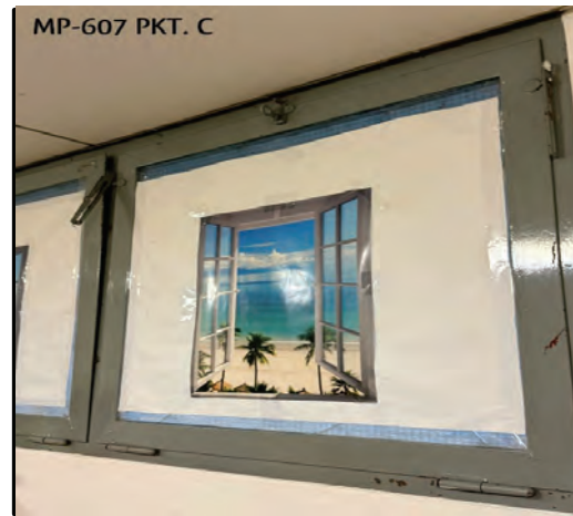
Bild 50: Punkt C Fensterkitt
