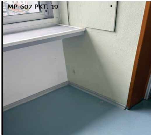
Bild 19: MP607-Pkt. 19, OG Mehrzweckraum, Kleber PVC
