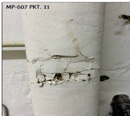
Bild 11: MP607-Pkt. 11, KG Heizung, Gipsmanschette Rohrleitung
