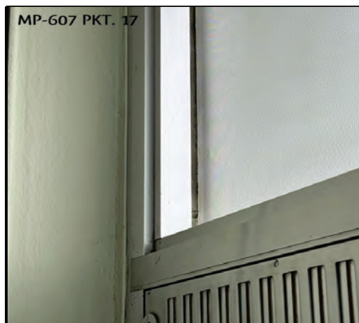
Bild 17: MP607-Pkt. 17, OG Mehrzweckraum, Fugenkitt Fenster
