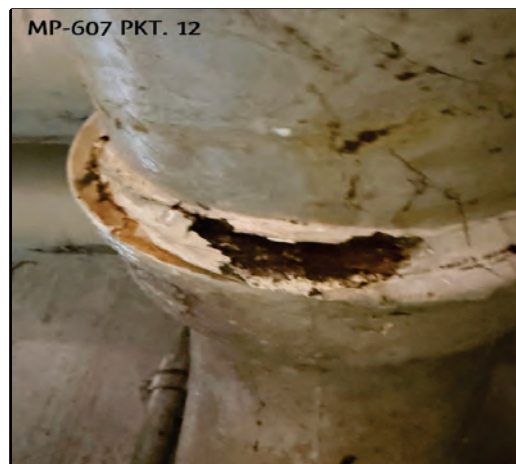
Bild 12: MP607-Pkt. 12, KG Materialraum, Kitt Gussrohr
