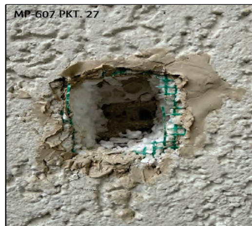
Bild 30: MP607-Pkt. 27, EG Hauptgebäude außen, Styropor unter Wandputz
