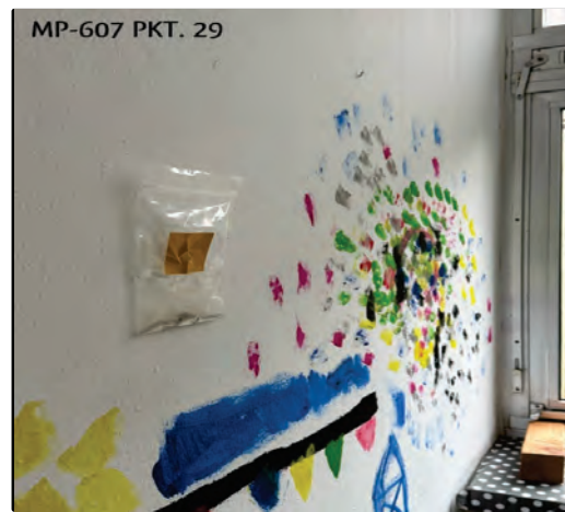
Bild 34: MP607-Pkt. 29, Putz innen -- Mischprobe
