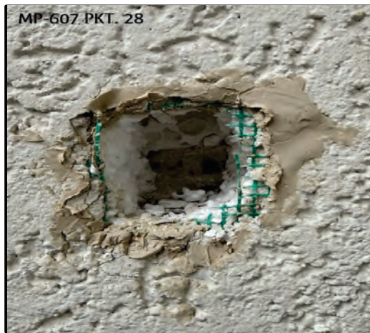
Bild 31: MP607-Pkt. 28, EG Hauptgebäude außen, Styropor unter Wandputz
