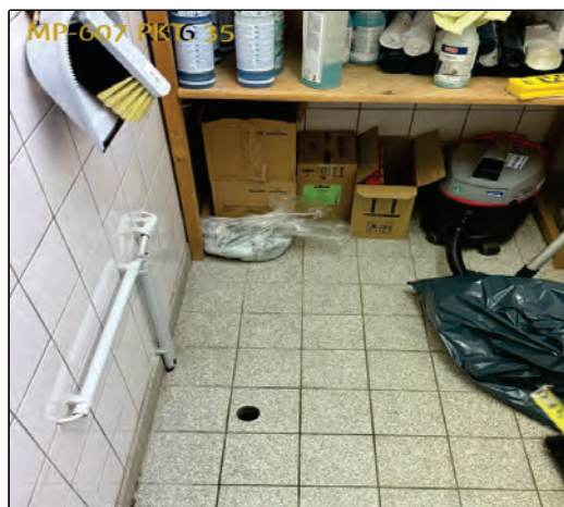
Bild 41: MP607-Pkt. 35, EG Mädchen WC Abstellraum, Bitumenbahn (aus KB 6)
