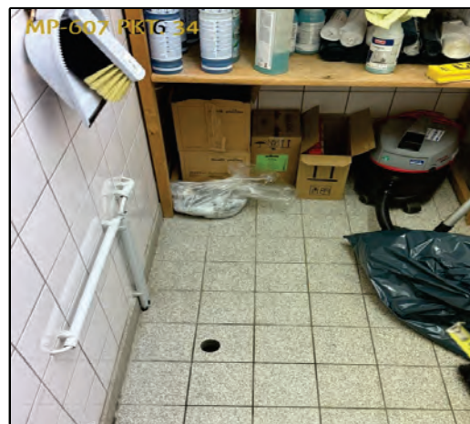
Bild 40: MP607-Pkt. 34, EG Mädchen WC Abstellraum, Kleber Bodenfliese
