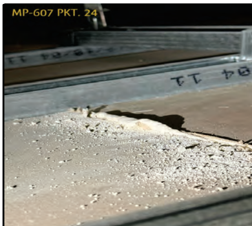
Bild 27: MP607-Pkt. 24, KG Essen und Personal, Spachtelmasse GK-Decke
